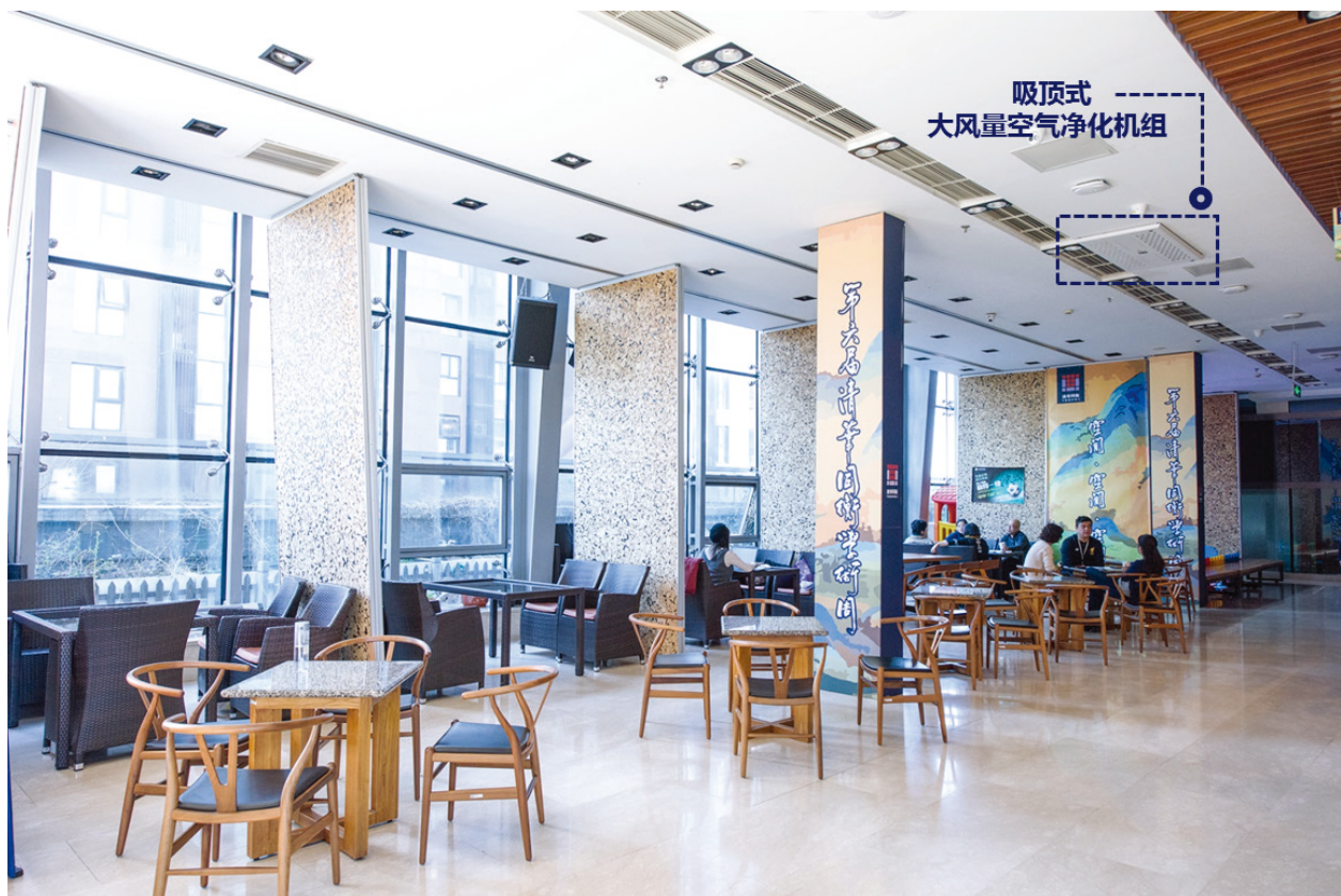
图24:办公区安装的吸顶式大风量空气净化设备
